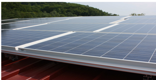
Unsere neue Photovoltaikanlage
